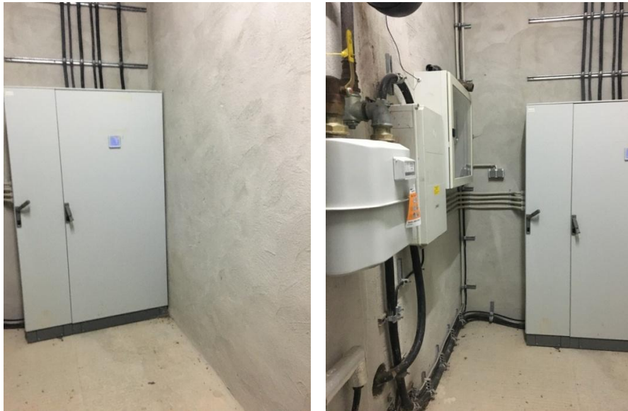
Niederspannungshauptverteilung und Zählerwechselschrank
