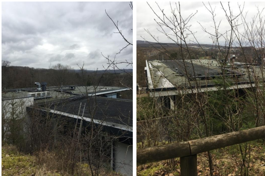
Teilflächen der vorhandenen Absorberanlage
